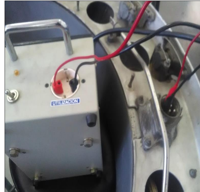
Terminales de la fuente de poder
