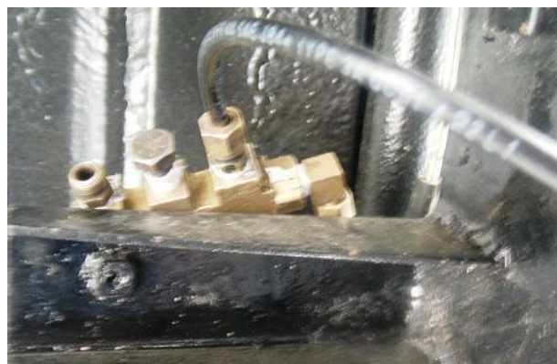
Figura 2.14 Conexión desde tanque principal hacia la válvula de repartición.
