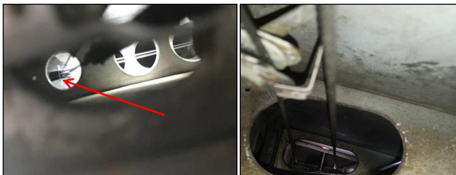
Figura 35 Verificación visual del enrutamiento de los cables
