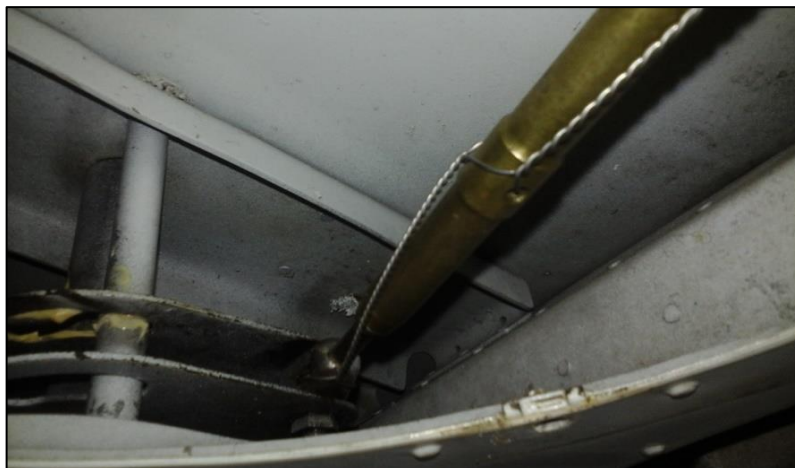
Figura 51 Entorchado de turnbuckles
