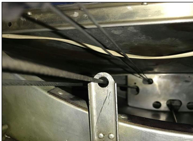
Figura 45 Verificación de movimiento de los cables
