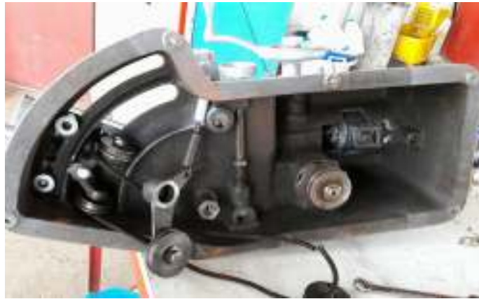
Figura 47 Limpieza de la máquina interior.
