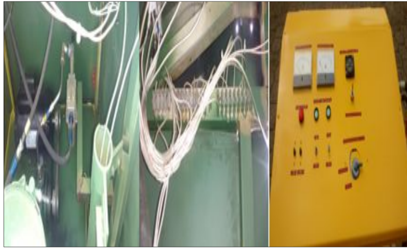
Figura 60 Conexiones hidráulicas, eléctricas
