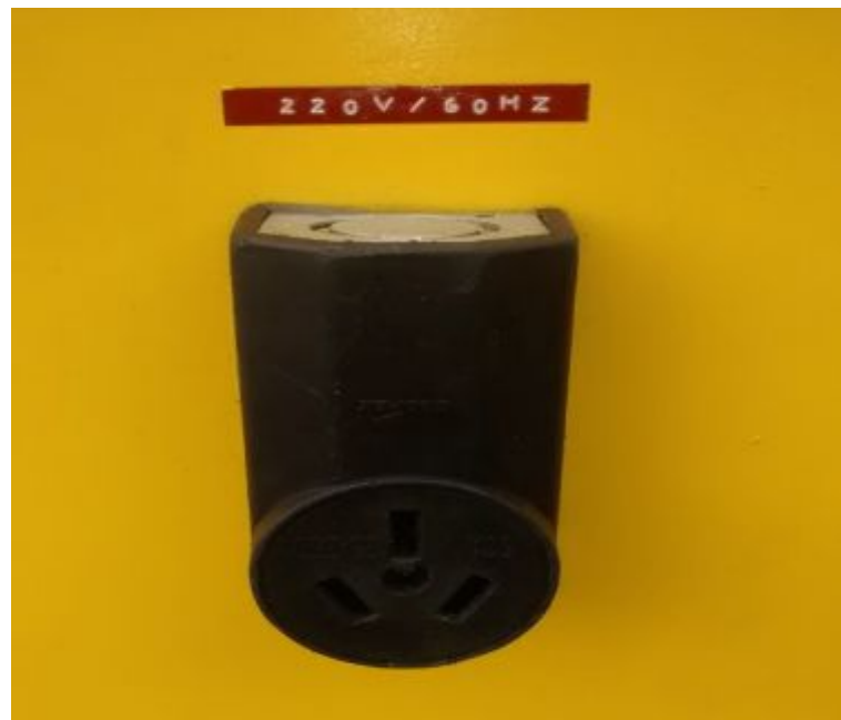
Figura 89 Toma de corriente de 220v
