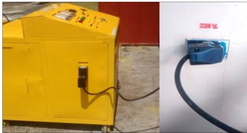
Figura 65 Toma de corriente a 220v
