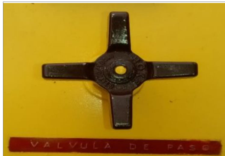
Figura 68 Válvula de paso cerrada
