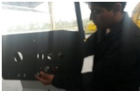
Figura 81 Instalación de los controles del motor.
