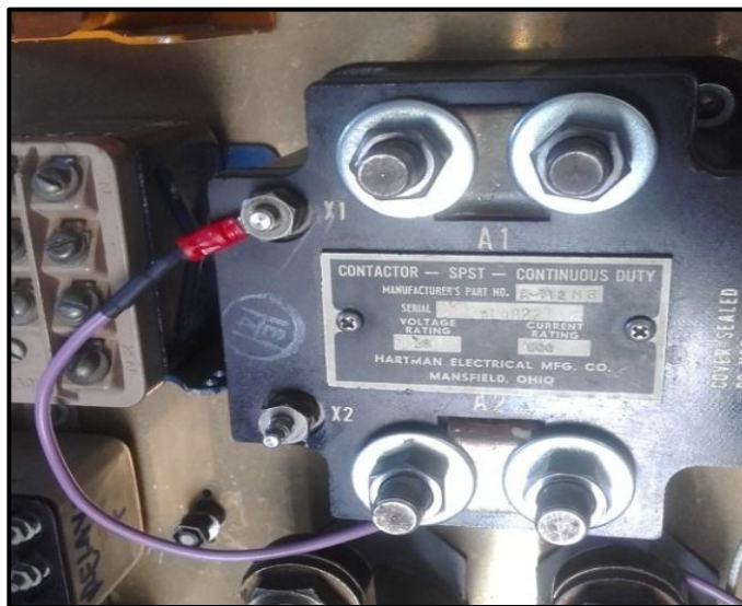
Figura 32 Cable conectado a relé.
