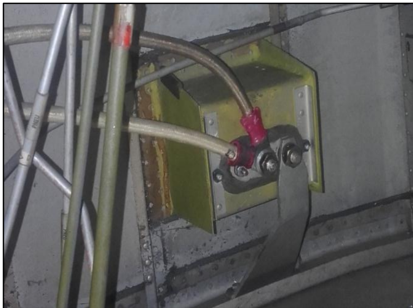
Figura 29 Extrenal Power Receptacle vista interna.
