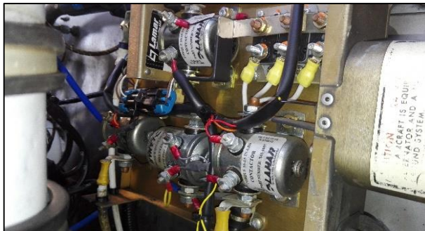
Figura 76 Inspección Visual de Caja de Conexiones de Potencia.
