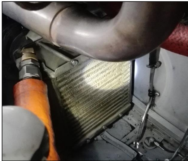
Figura 55 Inspección Del Enfriador De Aceite.
