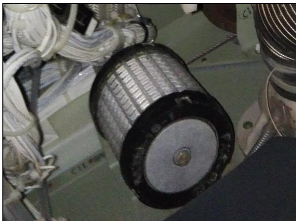
Figura 104 Inspección del Filtro del Sistema de Vacío.
