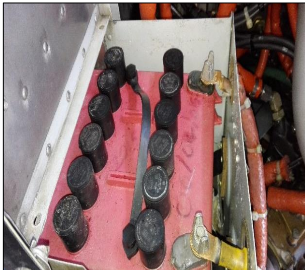
Figura 102 Batería de 24 V Cessna T206H.
