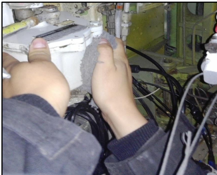
Figura 63 Limpieza del sensor de posición del PICH.
