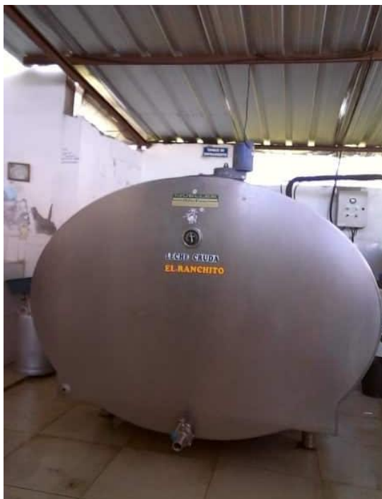
Figura 7 Tanque de enfriamiento
