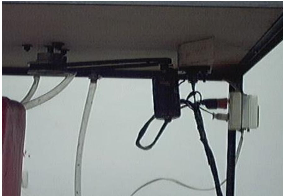
Fotografía A. 4. Polea, banda, motor eléctrico y mecanismos de control eléctrico
