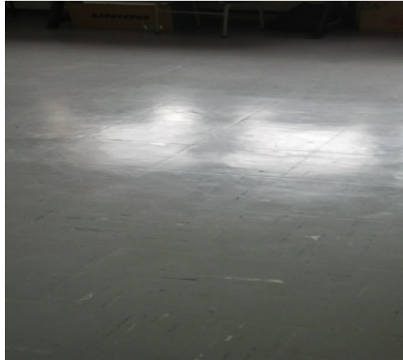
Figura 3.19 Lugar de Instalación Fuente: Investigación de Campo
