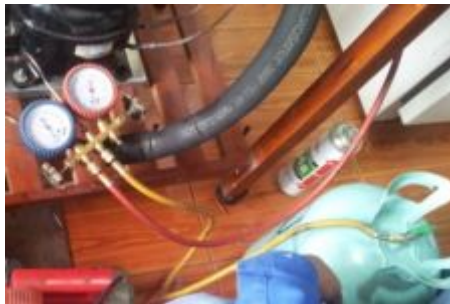
Figura 3.58: Disposición de las mangueras para ingreso del refrigerante
