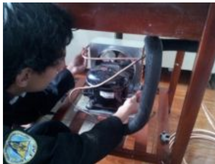
Figura 3.49: Unión del tubo con el compresor y el condensador
