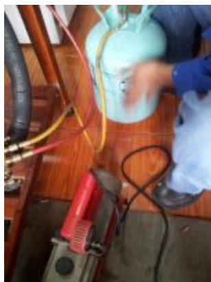
Figura 3.60: Carga del refrigerante
