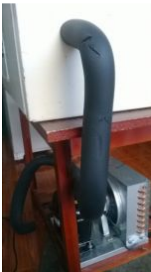
Figura 3.50: Aislante térmico cubriendo el capilar
