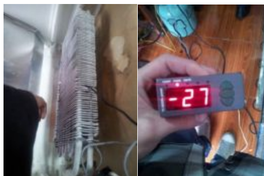
Figura 3.61: Prueba de funcionamiento, a la izquierda termocupla
