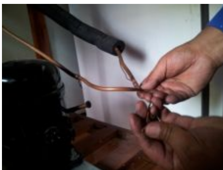
Figura 3.44: Tubo capilar a la salida del difusor
