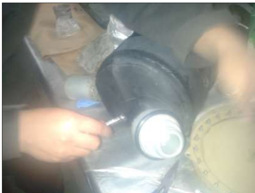
Figura 3. 21 Sellamiento con PRC del ducto de entrada del filtro
