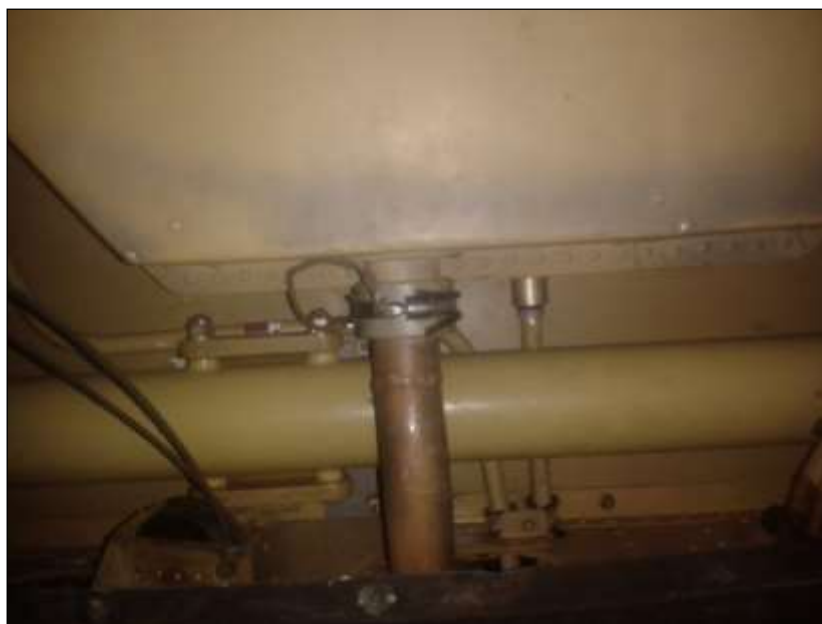
Figura 3. 25 Fuga de combustible
