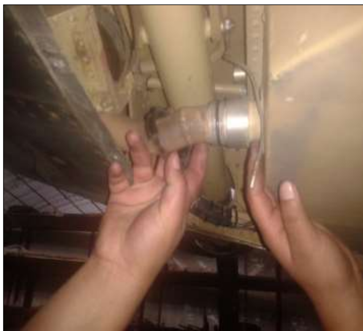
Figura 3. 17 Conexión de las cañerías de salida de combustible hacia el tanque.
