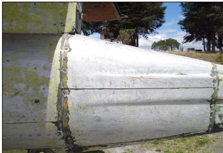
Figura 3. 20. Pintura muy adherida
