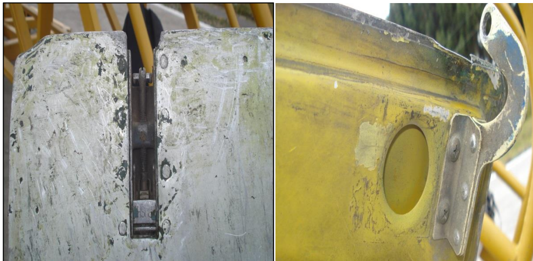
Figura 3. 4. Broches rotos y/o doblados
