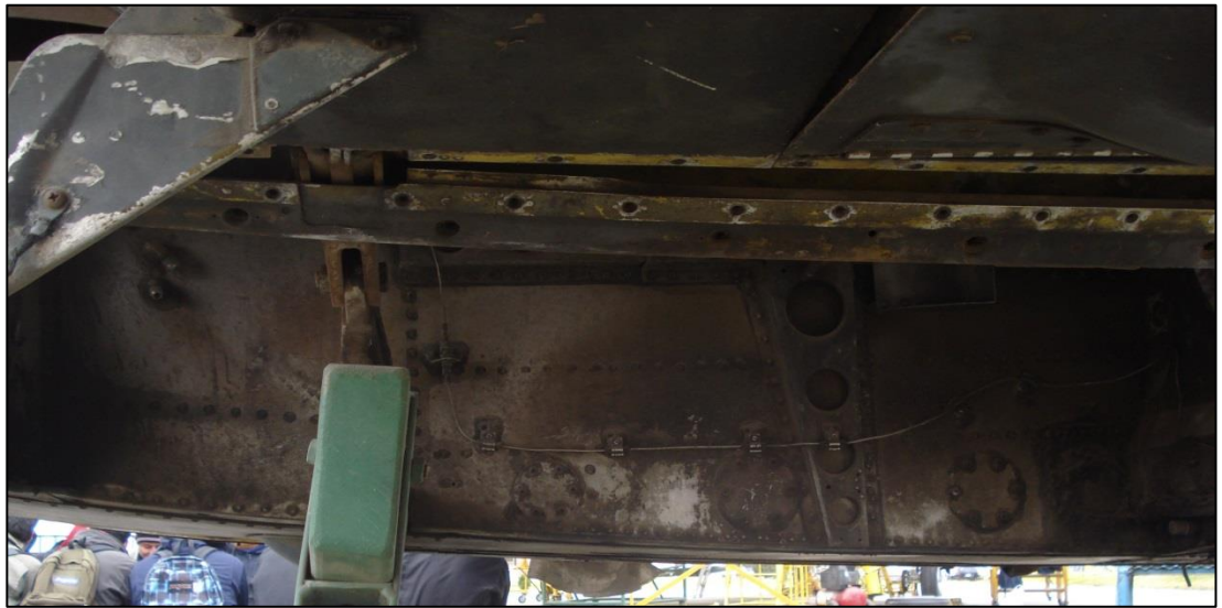
Figura 3. 12. Corrosión en la caja del tren de aterrizaje
