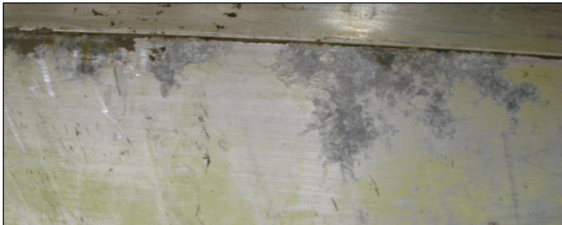
Figura 3. 10. Corrosión en traslapes
