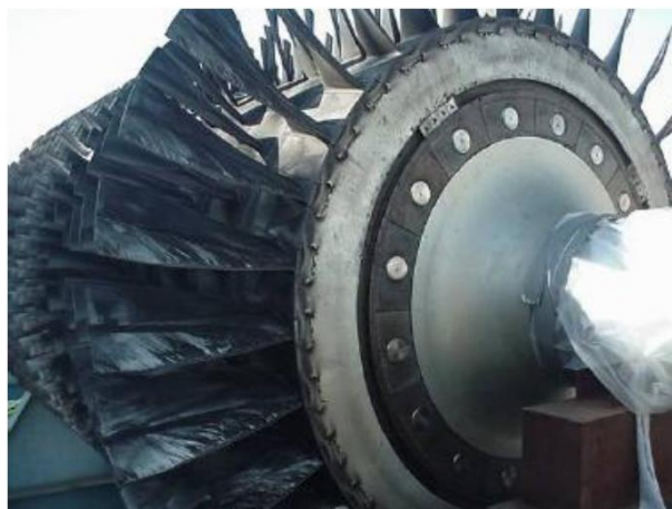
Figura 18. Depósito de grasa en alabes Fuente (HOMJI, 2009)
