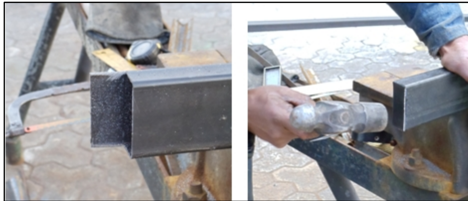
Fig. 3.16. Tapas en los extremos de los tubos Fuente: Sr. Coello Tapia Luis Angel
