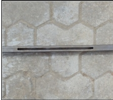
Fig. 3.23. Ranurado de los tubos de los brazos Fuente: Sr. Coello Tapia Luis Angel
