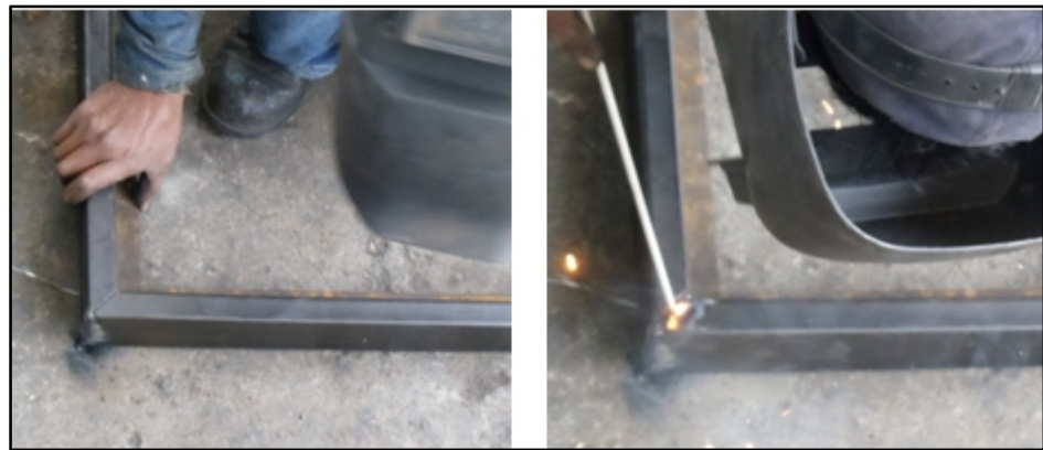
Fig. 3.14. Soldado de la estructura base Fuente: Sr. Coello Tapia Luis Angel
