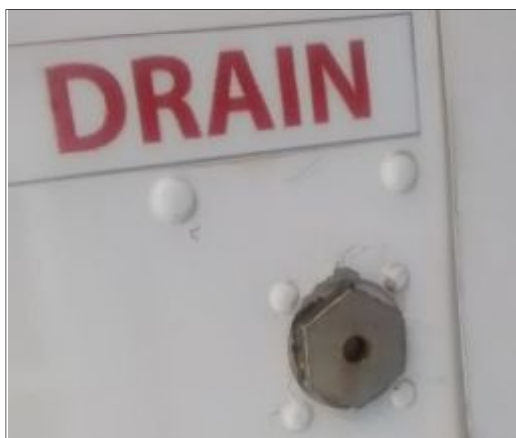
Figura 50. Válvulas de drenaje reemplazadas.
