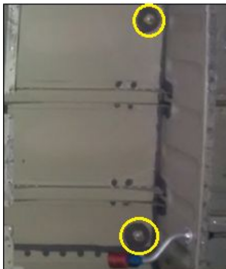
Figura 49. Válvulas de drenaje averiadas.
