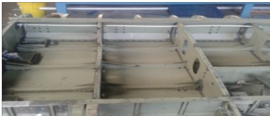
Figura 38. Estructura interna del tanque.
