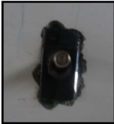
Figura. 75 Instalación del switch en el banco de pruebas
