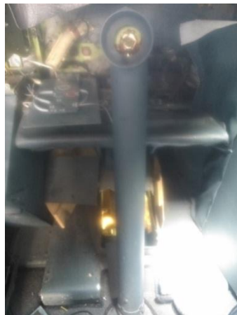
Figura 13: Estado inicial de la columna de control del primer oficial
