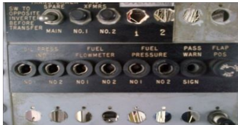
Figura 15. Circuit Breaker de los Flaps
