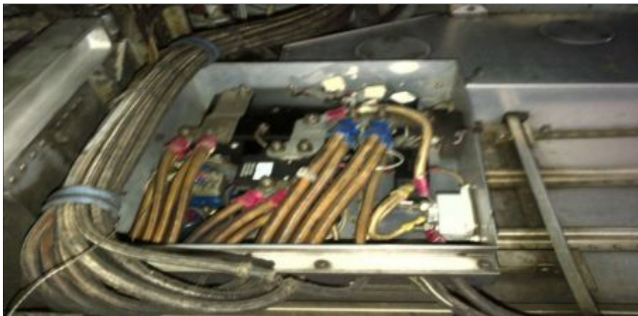
Figura 23. Caja de conexiones del actuador de los Flaps
