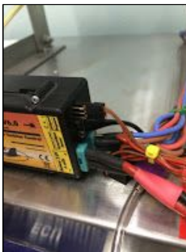
Figura 65. Posición del plug de la válvula shut-off de paso de gas propano
