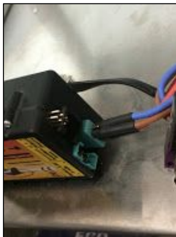
Figura 62. Posición del plug eléctrico a la turbina
