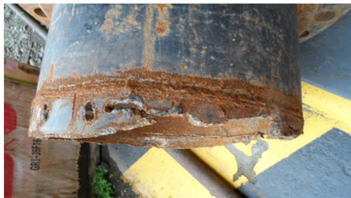
Figura 2.17. Corrosión por tensión
