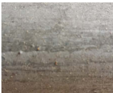
Figura 2.8. Grado de herrumbre A
