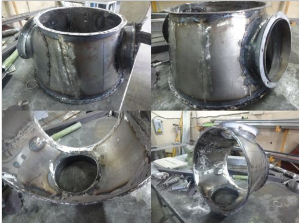
Figura 3.18 Exhaust duct Case lijado y pulido
