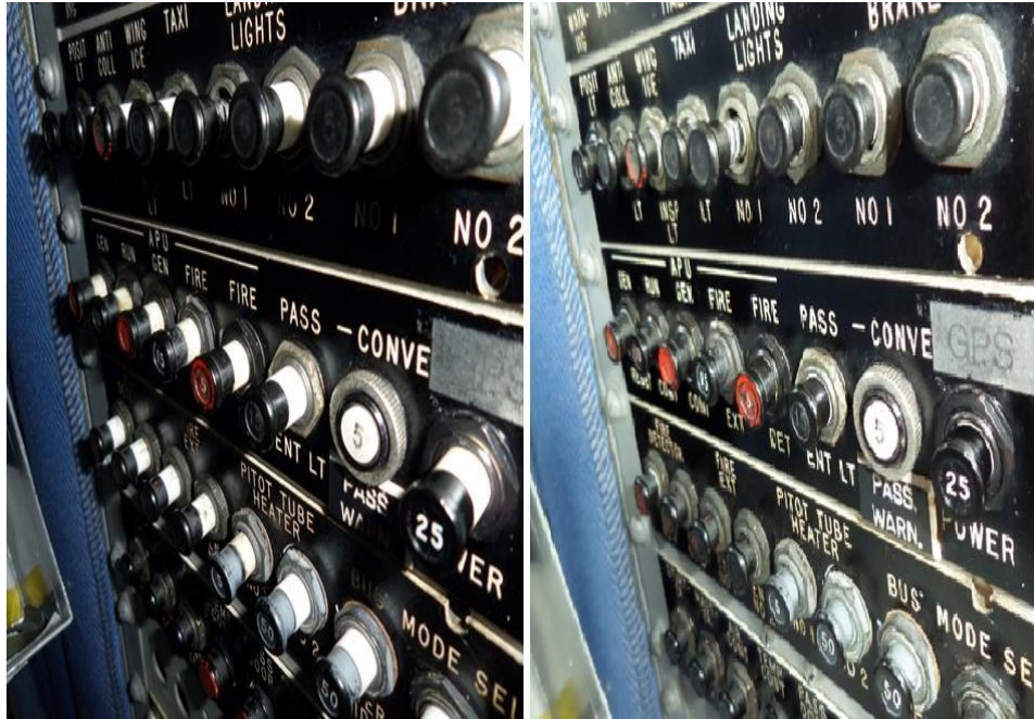
Panel de circuit break abierto y cerrado
