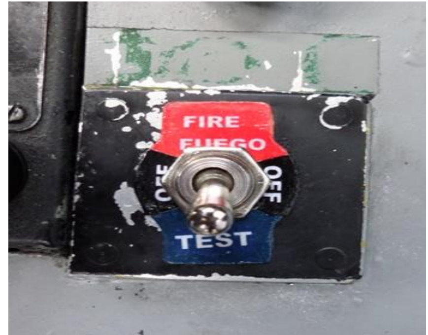
Switch de tres posiciones
