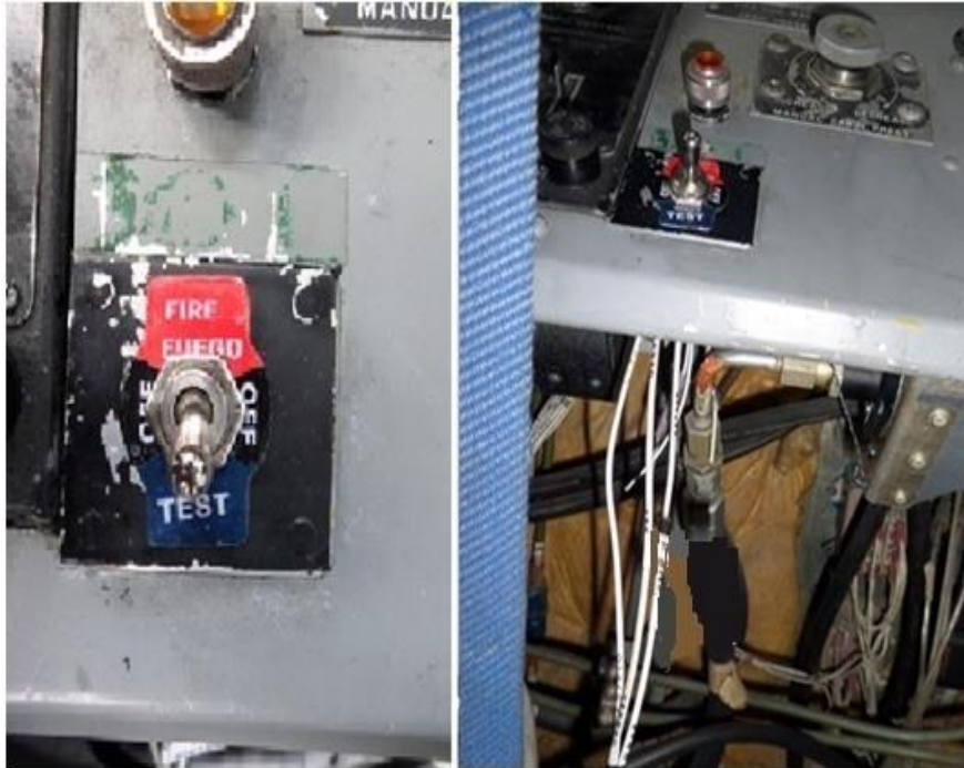
Conexión del cableado a switch de tres posiciones.
