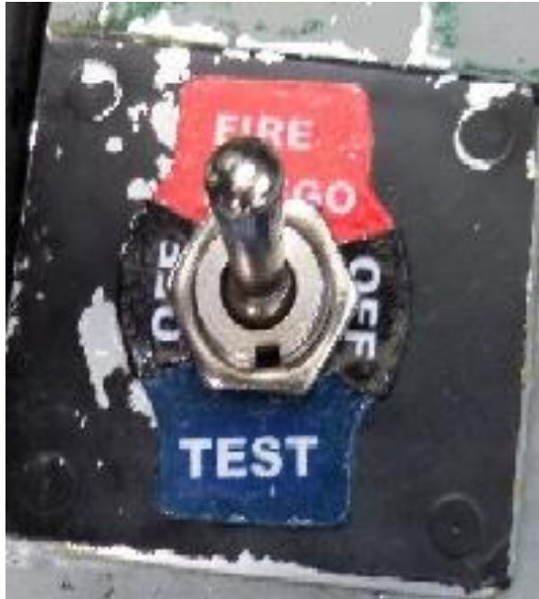
Switch en FIRE
