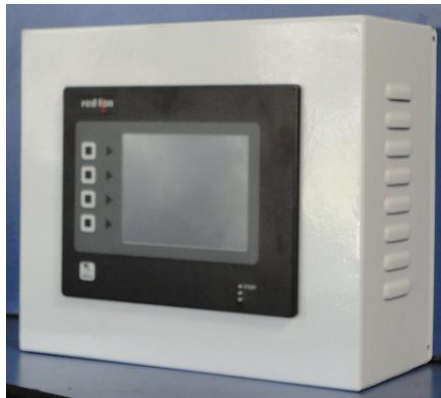
Figura 3.31: Vista del tablero de supervisión
