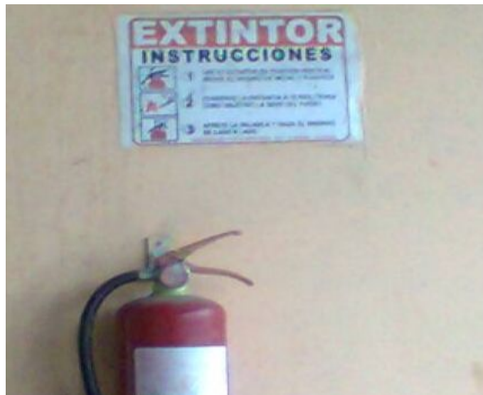
Figura N° 14 Extintor con sus debidas instrucciones
