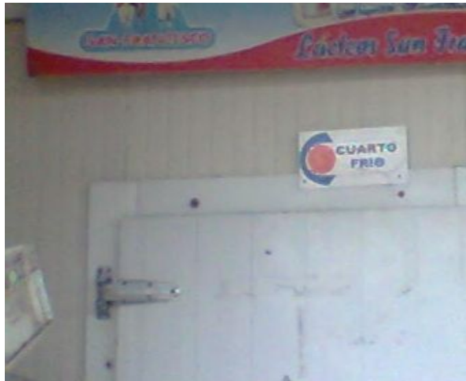
Figura N° 12 Área de almacenaje-Cuarto Frio
