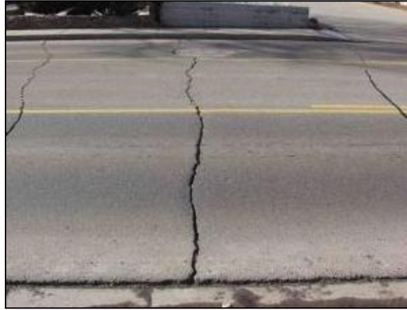
Figura 7.9: Fisura transversal (Fuente: Sellado de juntas y grietas, correcta aplicación y evolución en Latinoamérica Lic. Patricia Irrgang)
