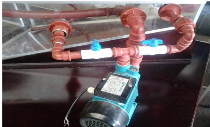
Figura 3.13: Salida de la bomba
