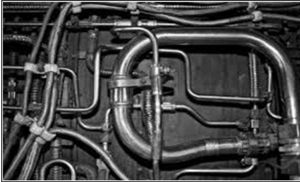
Figura 2.4 Tuberías de combustible
