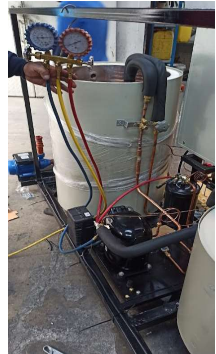
Carga de Refrigerante
