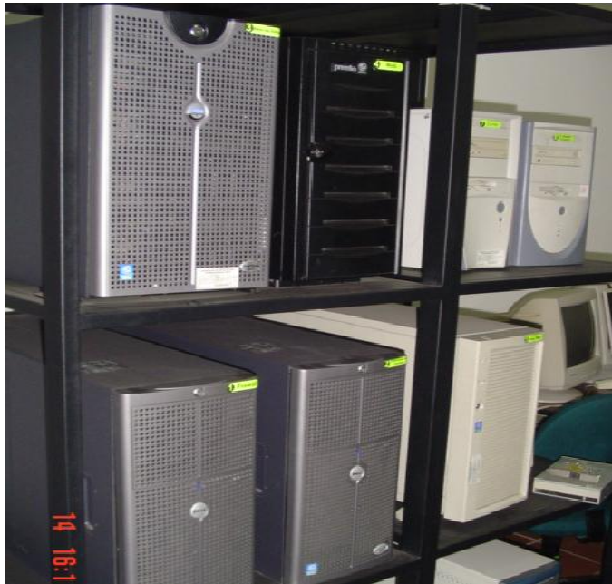
Figura 1.4. Sala de Servidores.
