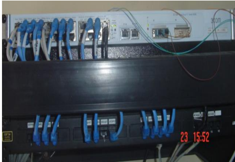
Figura 1.5. Rack del Centro de Datos 8.
