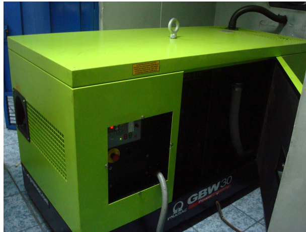
Figura 2.1: Generador de energía Eléctrica
