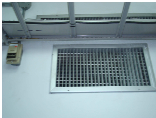
Figura 2.4: Ductos de aire acondicionado
