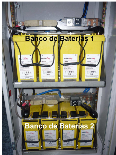
Figura 2.7: Banco de baterías del Rectificador Siemens GSM
