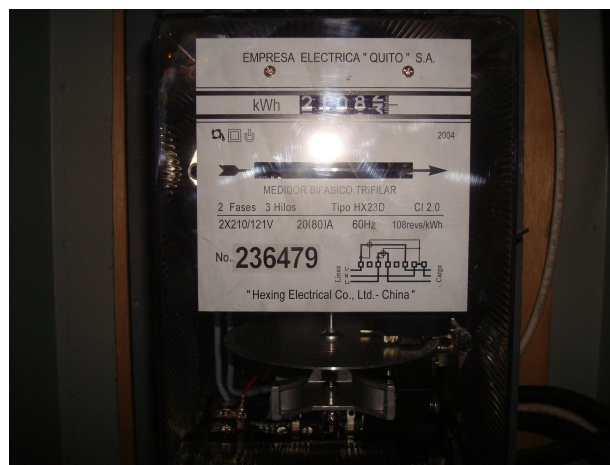
Figura 2.13: Medidor de energía eléctrica
