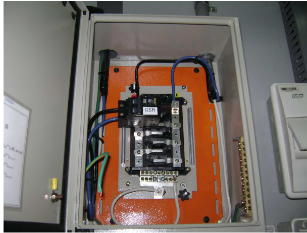
Figura 2.5: Tablero AC GSM
