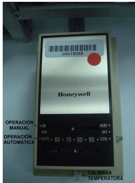
Figura 4.1: Controlador del AA
