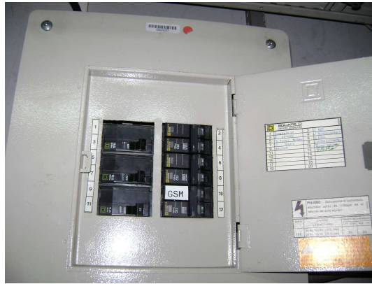
Figura 2.3: Tablero de distribución de equipos - TDE
