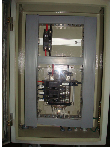
Figura 2.16: TDE de la estación outdoor
