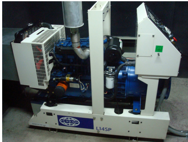
Figura 2.14: Generador de energía eléctrica
