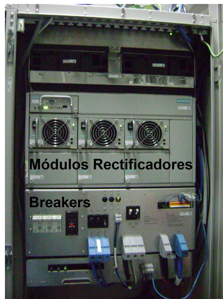
Figura 2.6: Rectificador BTS Siemens GSM
