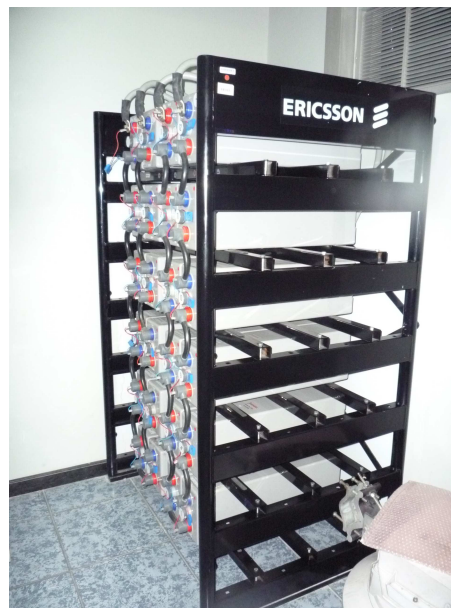
Figura 2.9: Banco de baterías del Rectificador Ericsson
