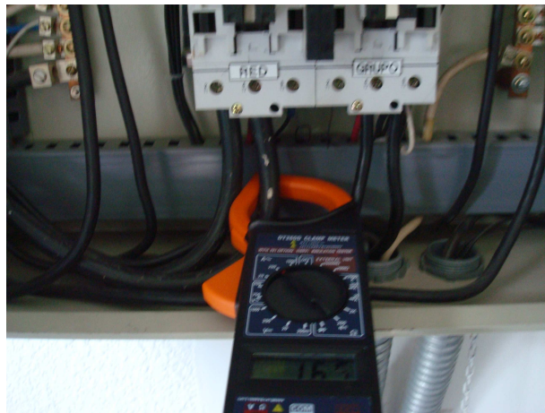
Figura 2.24: Punto de medición, BTS completa
