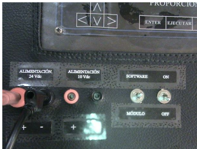
Figura 9.- Interruptor de control de switcheo
