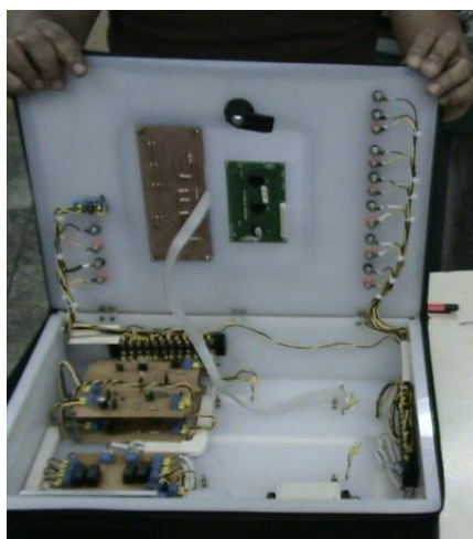
Figura 3.16 Estructura interna del rack
