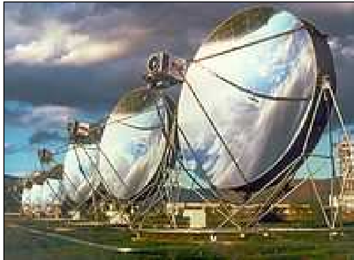
Figura 1.22 Colectores solares parabólicos que concentran la radiación solar aumentando temperatura en el receptor. 25
