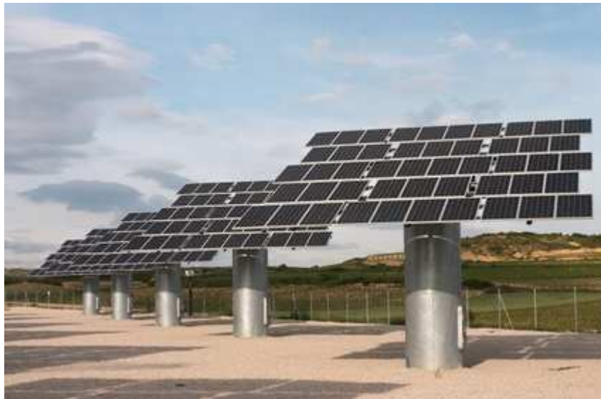
Figura 1.26 Batería de paneles solares. 29
