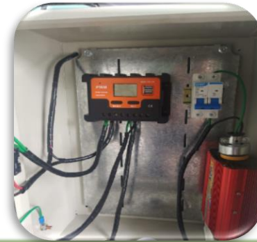
Elementos eléctricos y electrónicos dentro del gabinete
