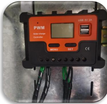
Conexión de la batería y panel
