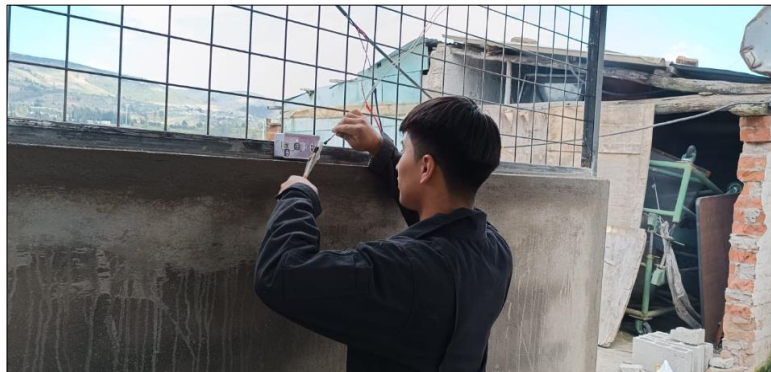
Instalación eléctrica del almacenamiento
