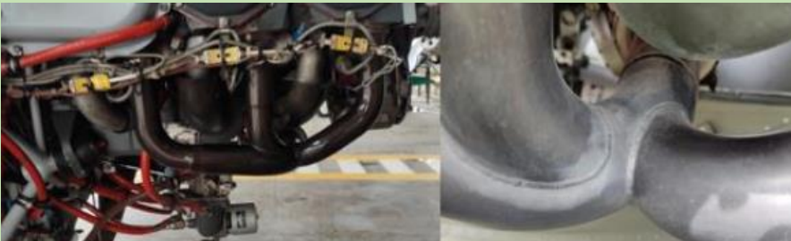
Sistema de escape del motor
