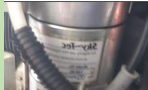
Inspección motor de arranque
