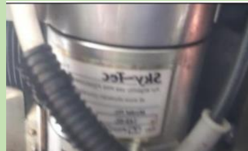
Inspección motor de arranque
