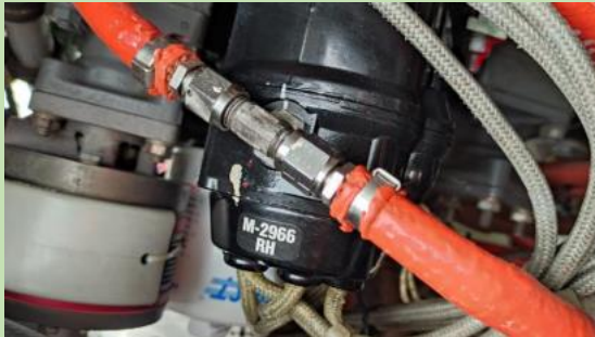
Inspección y mantenimiento de magnetos
