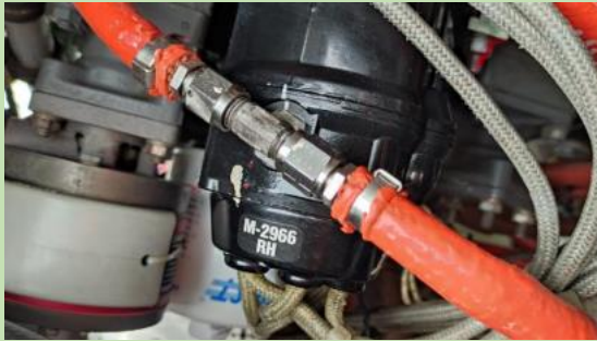
Inspección y mantenimiento de magnetos
