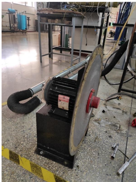
Estado de Motor y turbina del Equipo Torre de enfriamiento
