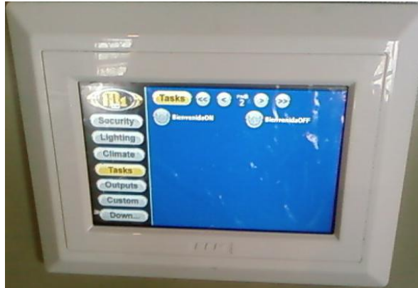
Figura 4.11 Activación y desactivación de tareas en la pantalla táctil
