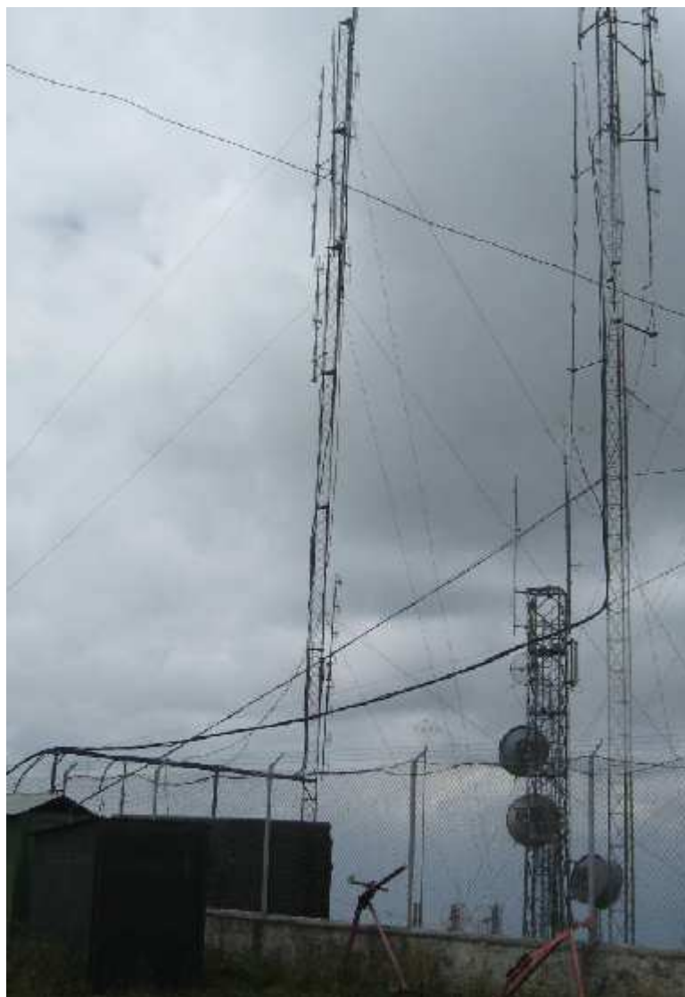
Figura 3.59. Estación repetidora de la ESPE instalada en la propiedad del Comando Conjunto de las FF.AA. ubicado en Cruz Loma
