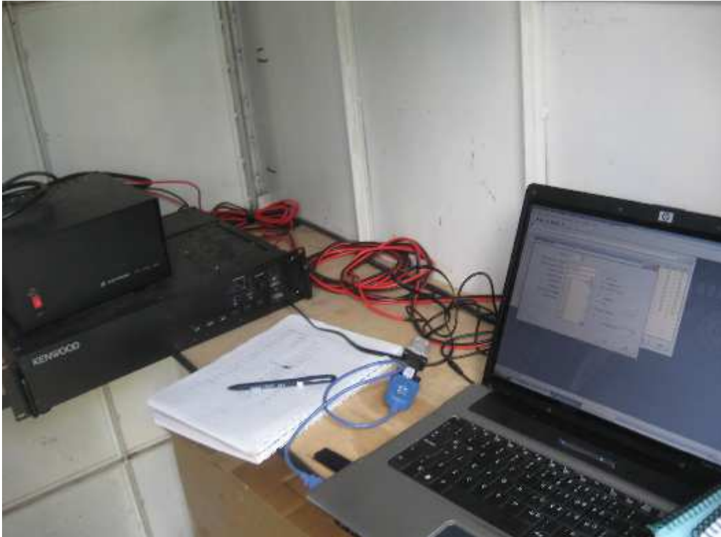
Figura 3.60. Conexión de administración entre una PC y la estación repetidora de la ESPE
