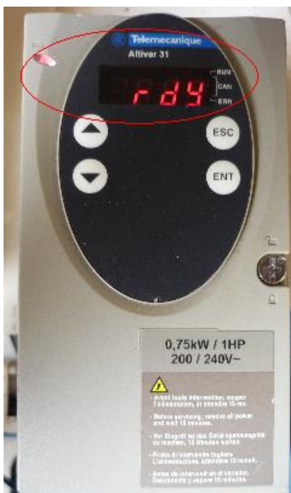
Figura 5.18 Verificación de encendido de Variador de Velocidad
