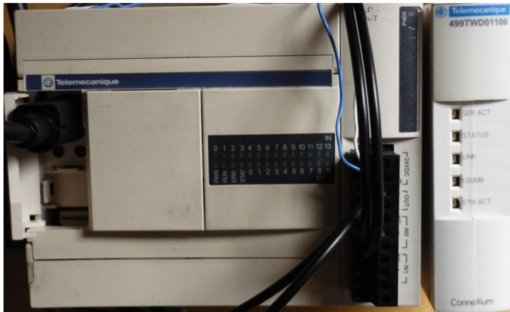
Figura 3.3 PLC con módulo de Análogas y Ethernet
