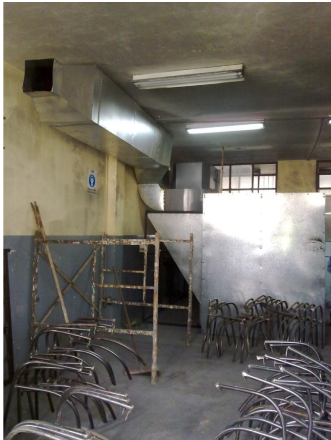
Ducto de salida completo
