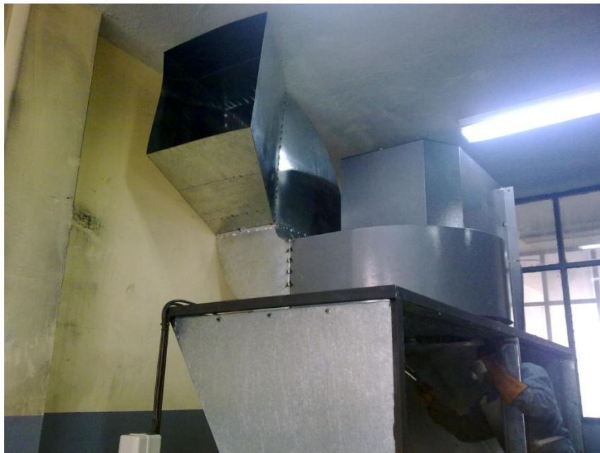
Configuración del ducto de salida instalado
