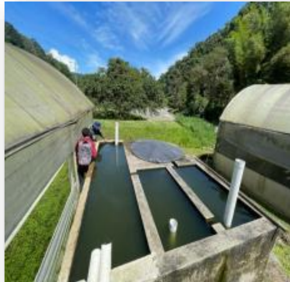
Sistema de Nitrificación
