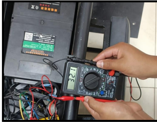
Medición Pack de batería
