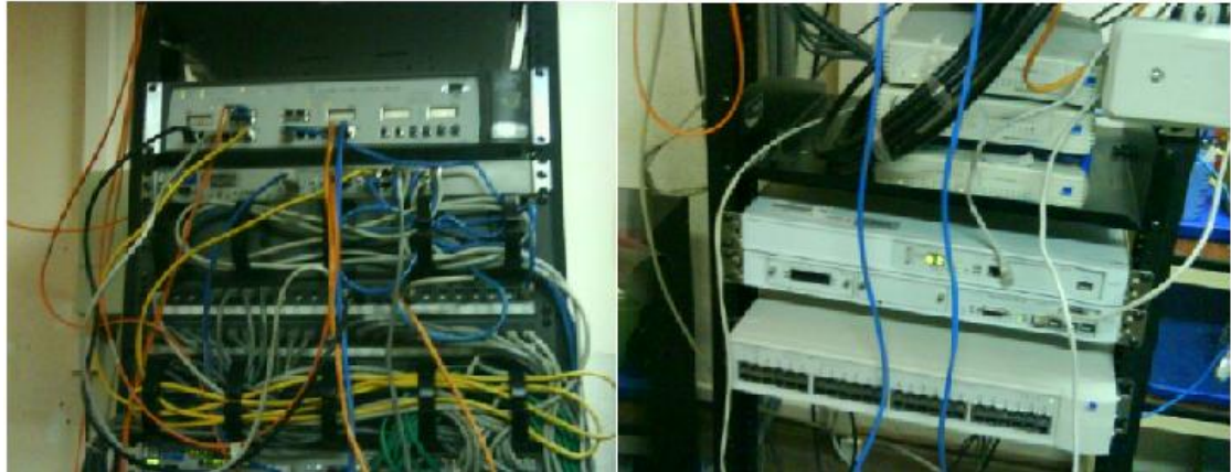
Figura. 3.20. Rack del Centro de datos
