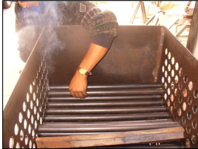
Figura 5. 8 Intercambiador de Calor, Alineación de tubos
