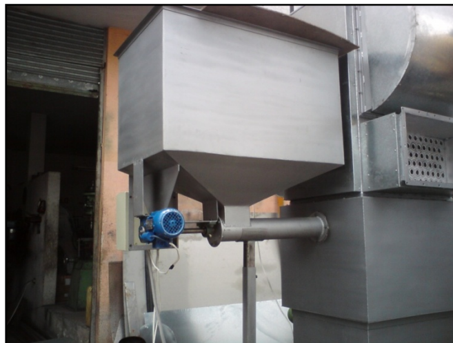
Figura 5. 49 Montaje de Motor reductor, vista Lateral
