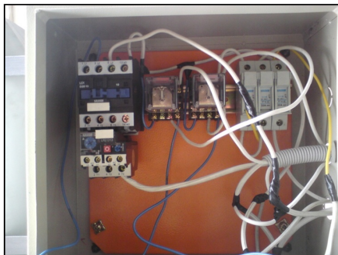
Figura 5. 53 Conjunto de protecciones
