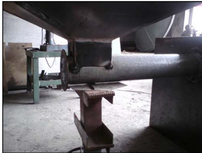
Figura 5. 31 Tolva de alimentación, Brida de conexión y ducto de ingreso de Biomasa
