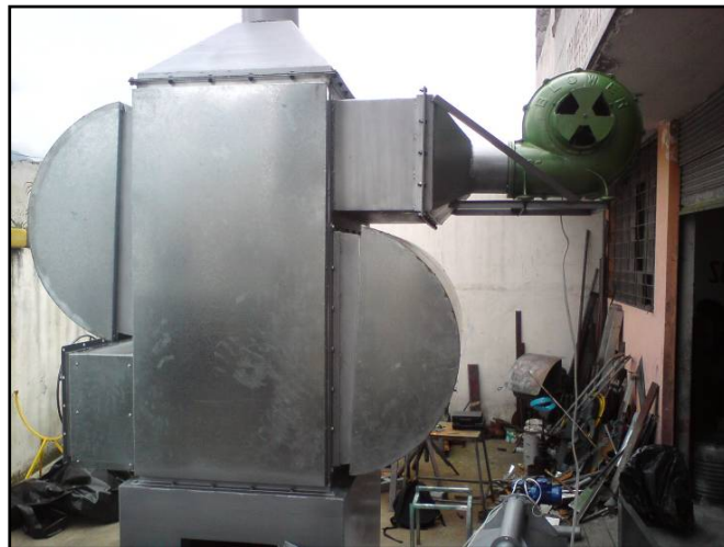
Figura 5. 46 Montaje de Venterol de 6" para alimentación de aire
