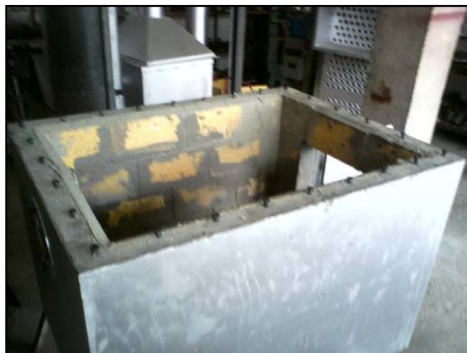
Figura 5. 5 Cámara de Combustión, Ladrillo refractario
