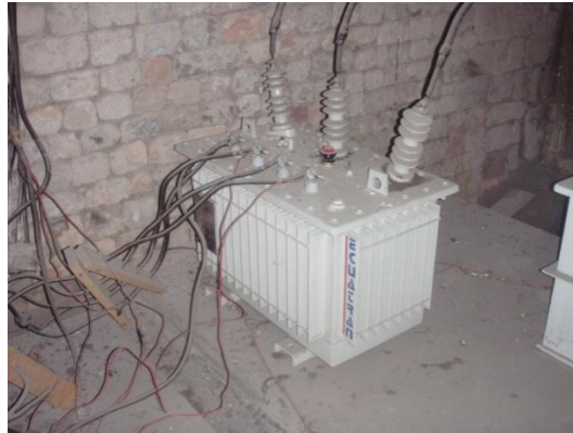
Figura 3.3. Transformador de 75 kVA.
