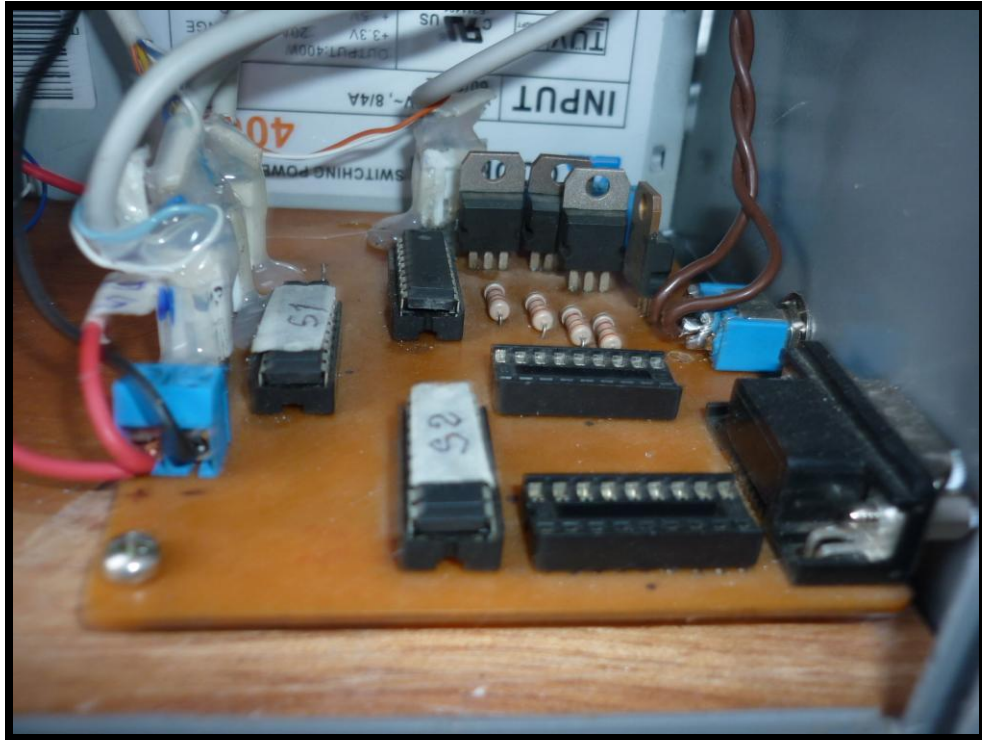
PLACAS ELECTRONICAS DE CONTROL Y FUERZA
