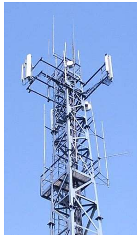
Fig. 1.17. Estación Base GSM
