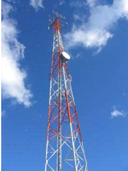
Fig. 1.15. Estación base de telefonía móvil
