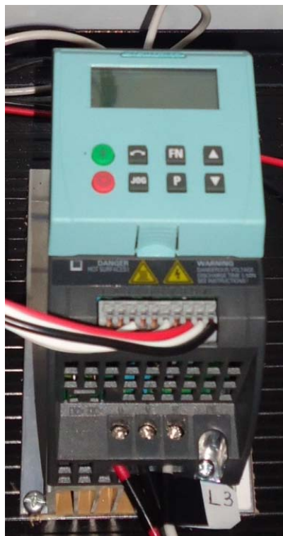
Figura 2 Variador de frecuencia
