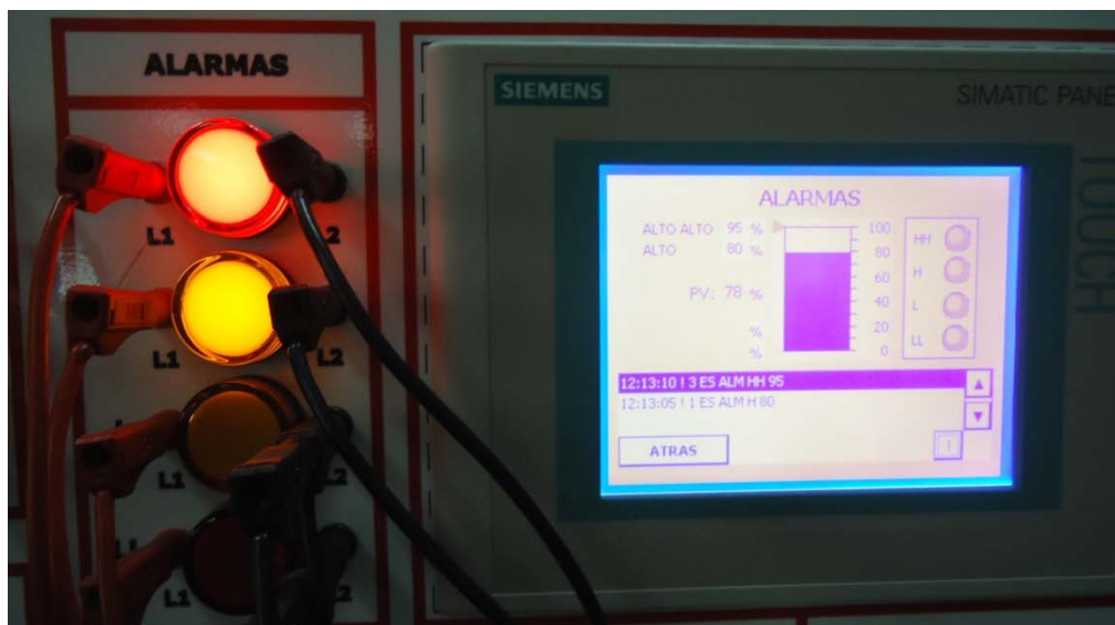
Figura 3. 27 Luces piloto y pantalla de registro de alarmas
